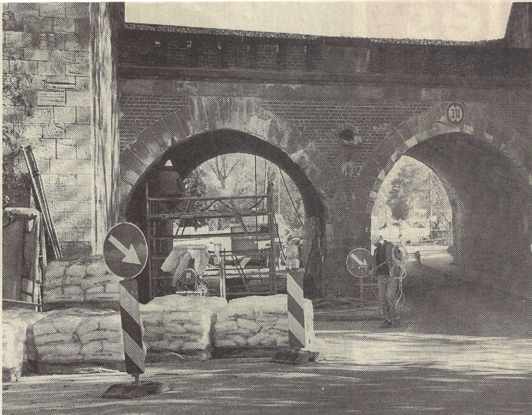
Beide Gewölbetunnel der 1880 erbauten Eisenbahnbrücke bei Malsfeld waren sanierungsbedürftig. Die Arbeiten werden bald abgeschlossen sein. (Foto: Müller-Neumann)
