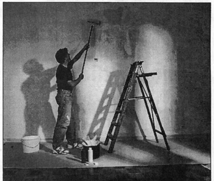
Das Deckvermögen besonders strapazierfähiger Wandfarben, sogenannte Latexfarben, ist ausgezeichnet. In den meisten Fällen reicht daher ein einmaliges Auftragen der Farbe. Auch werden Unebenheiten, Verschmutzungen und Tapetenüberlappungen in einem Arbeitsgang ausgeglichen und überdeckt. (wwp) Foto: DLI
