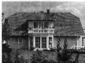
(spp) Dacheindeckung: Tessiner Pfanne Novo von Braas.
