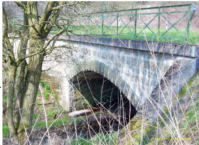
Die Südseite der Vockebrücke mit Wasseraustritt am 9. April 2007.
