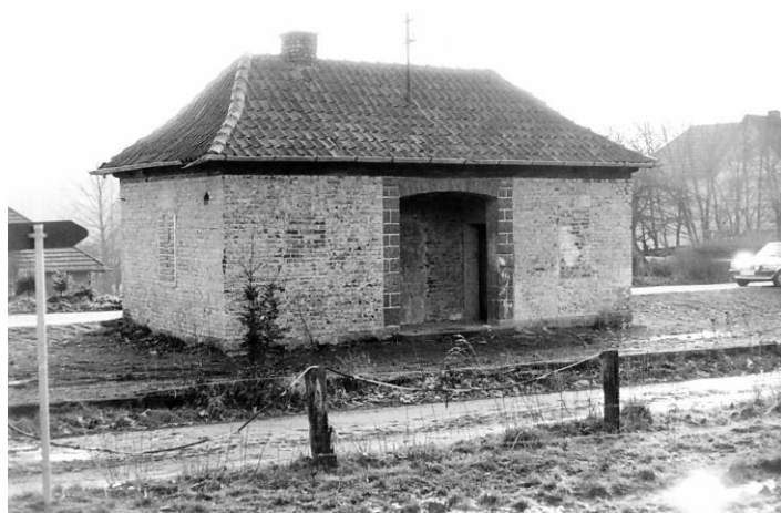
Das heruntergekommene Gebäude vom Haltepunkt Pfieffe im Januar 1983.
