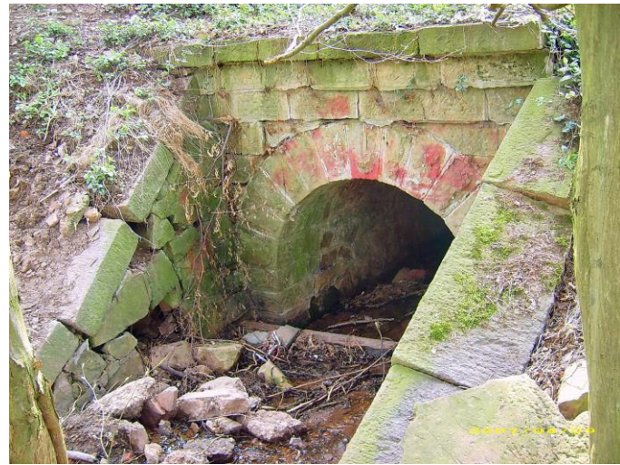
Die Nordseite vom Wasserdurchlass mit roten Farbresten am 09. 04. 2007.
