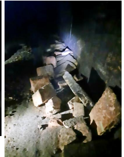
Freigelegter trockener Wassereinlauf im Tunnel.
