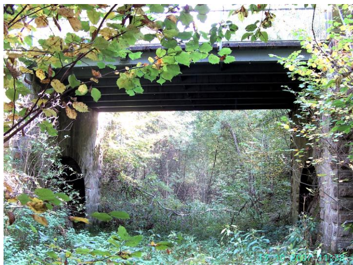
Blick am 13. 10. 2007 unter der Brücke hindurch auf die zugewachsene
