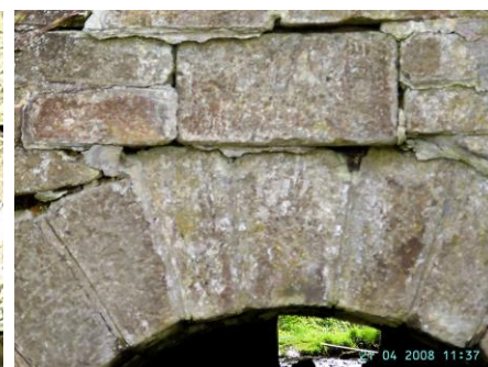
Der Schlussstein an der Nordseite des Gewölbes am gleichen Tag mit Resten der Jahreszahl 1876 darüber.
