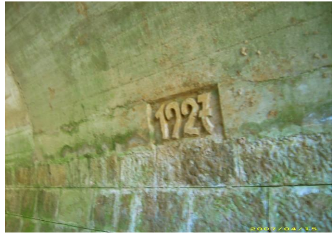
Die Jahreszahl 1927 im Inneren des Gewölbes von der Flutbrücke am 15. 04. 2007.
