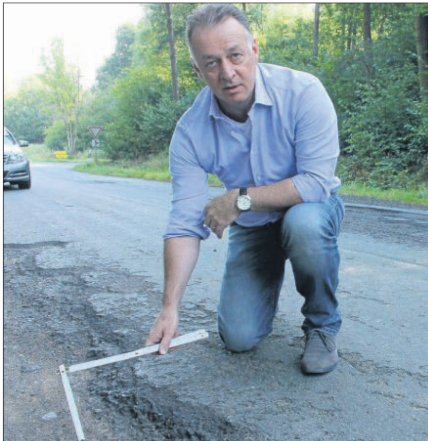
Tiefe Risse in der Straße: Michael Böse, Ortsvorsteher von Beiseförth, zeigt die betroffenen Bereiche, an denen es besonders schlimm ist.
