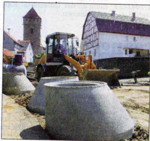
Dicke Rohre werden in Dagobertshausen im Untergrund versenkt. Der Kanalbau dort kostet 600 000 Euro.
