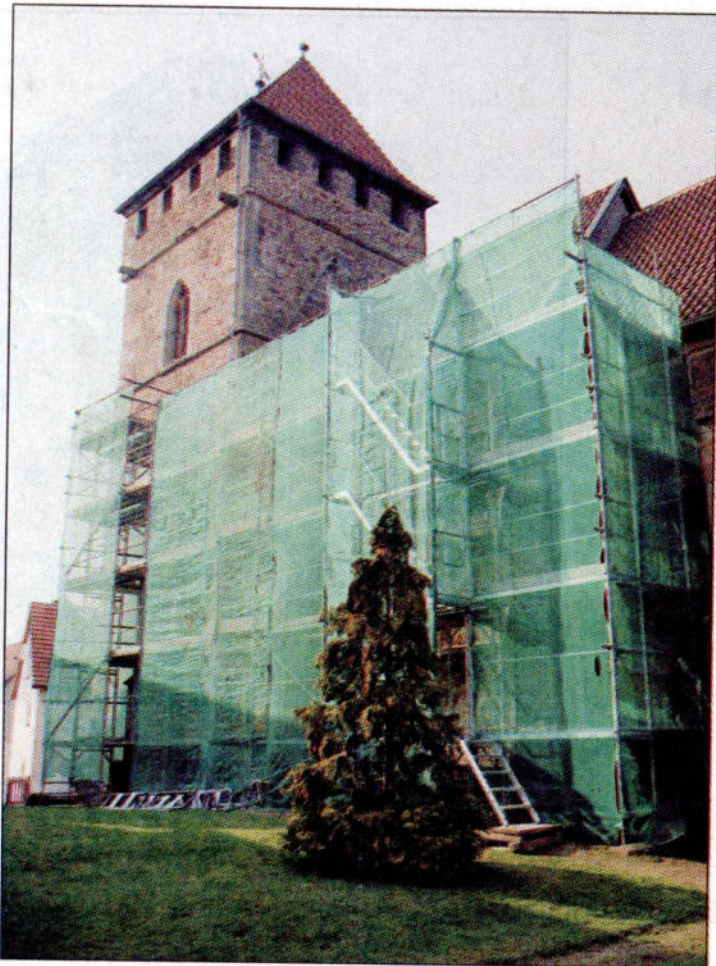
Schädlicher Zementmörtel wird derzeit aus den Fugen gekratzt, weil er den Stein der Kirche von Dagobertshausen zerstörte. Kalkmörtel nach historischem Vorbild muß nun in mühsamer Handarbeit in die Mauern injiziert werden. (Fotos: Stier)
